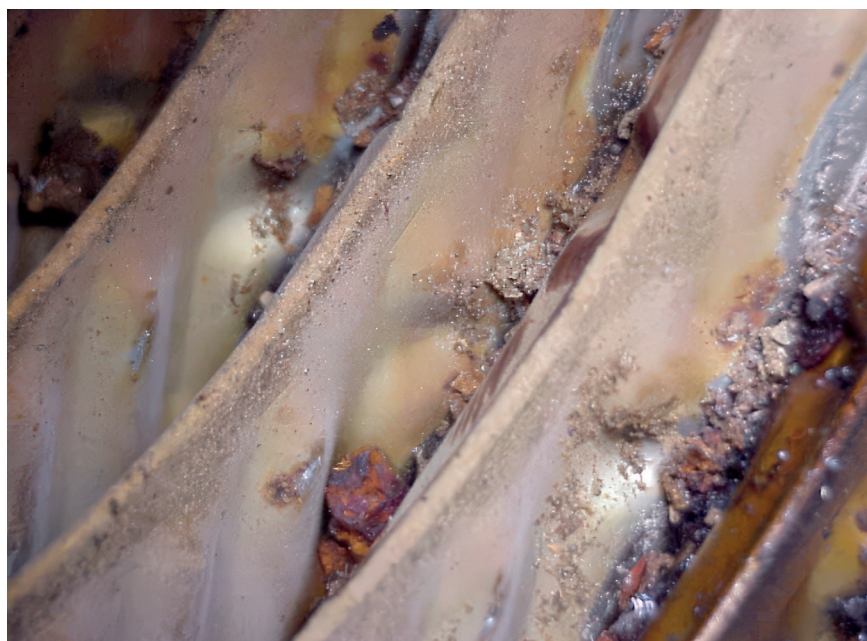
Fig. 1: Corrosie in een warmtewisselaar (J. Schröer).
