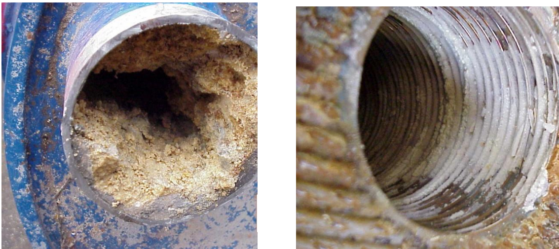
Vervuiling door kalk met chloride concentraties
