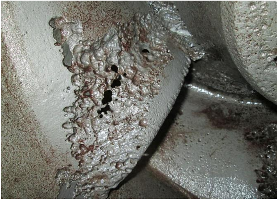
Fig. 3: Cavitatieschade aan een pompwaaier.
