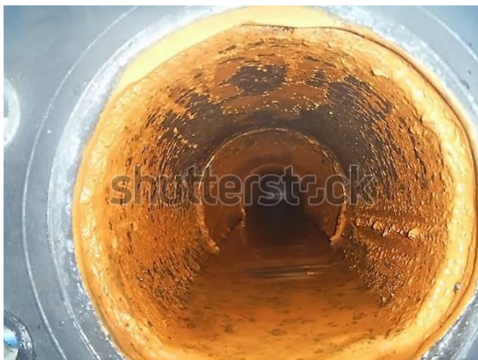
Fig 1: Corrosie van leidingwerk.
