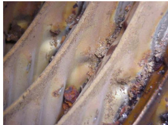
Fig 2: Corrosie in een warmtewisselaar.
