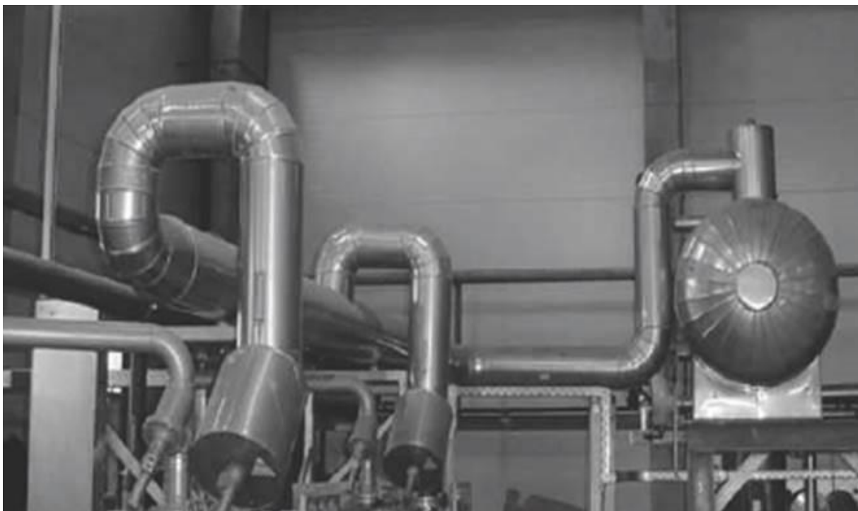
Fig. 1 Leidingtraject met potentieel risico op condensaatverzameling in droge zuig (bron: GTEX).
