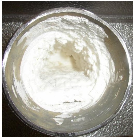
Fig 4. Gevolgen van een CO 2 /NH 3 lekkage
