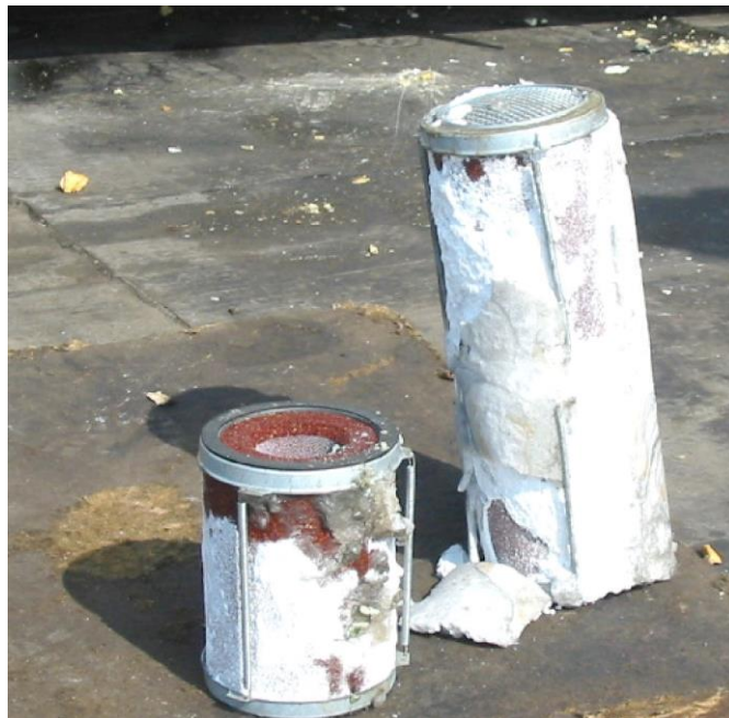
Figuur 4: Met water verzadigde filter/drogers
