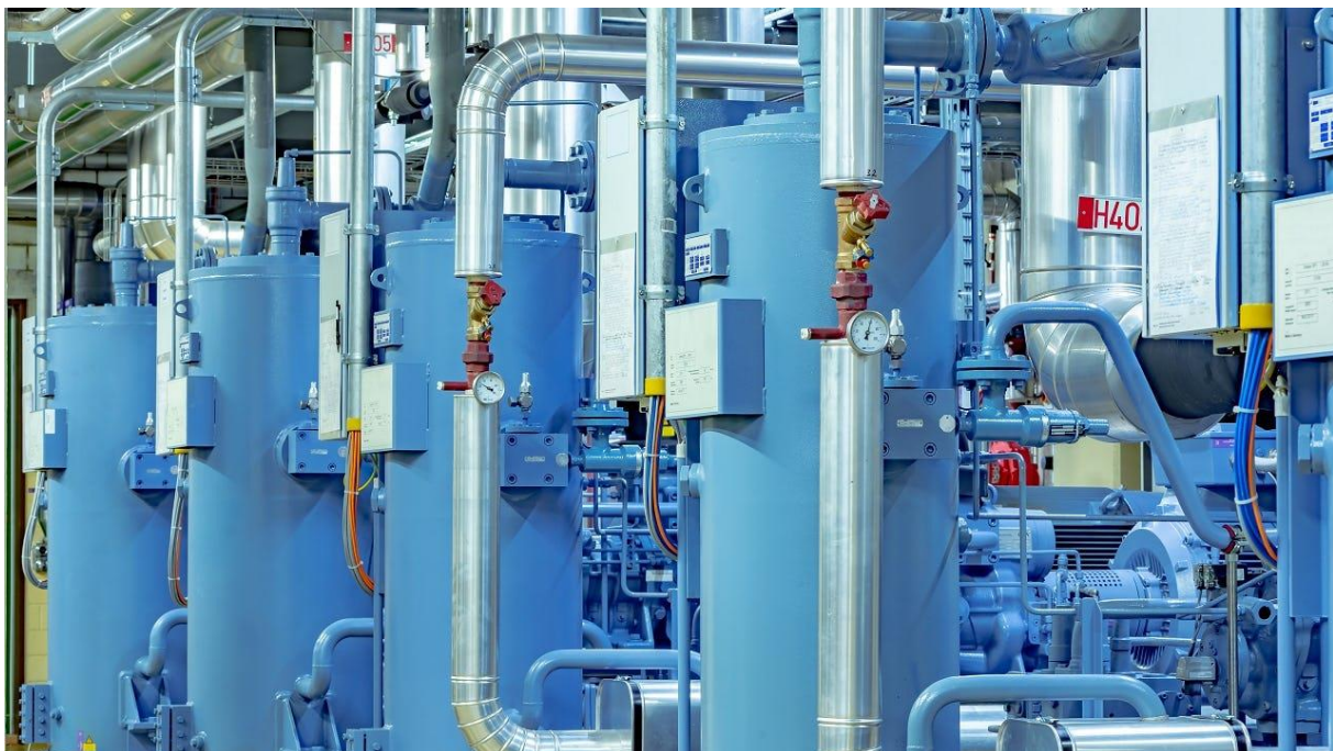
Fig 1. Voorbeeld van een koelinstallatie gevuld met ammoniak als koudemiddel.
